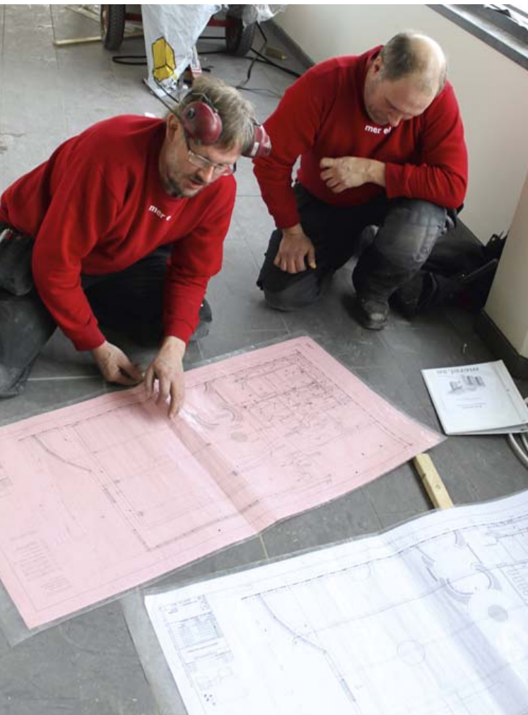
Montörerna måste försöka noggrant följa ritningarna. Ibland stämmer de inte med verkligheten.
